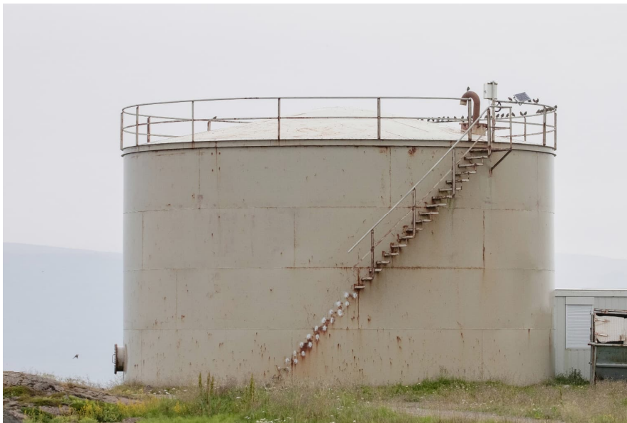
Mynd 14.2 Vatnsveita í Búðardal.
